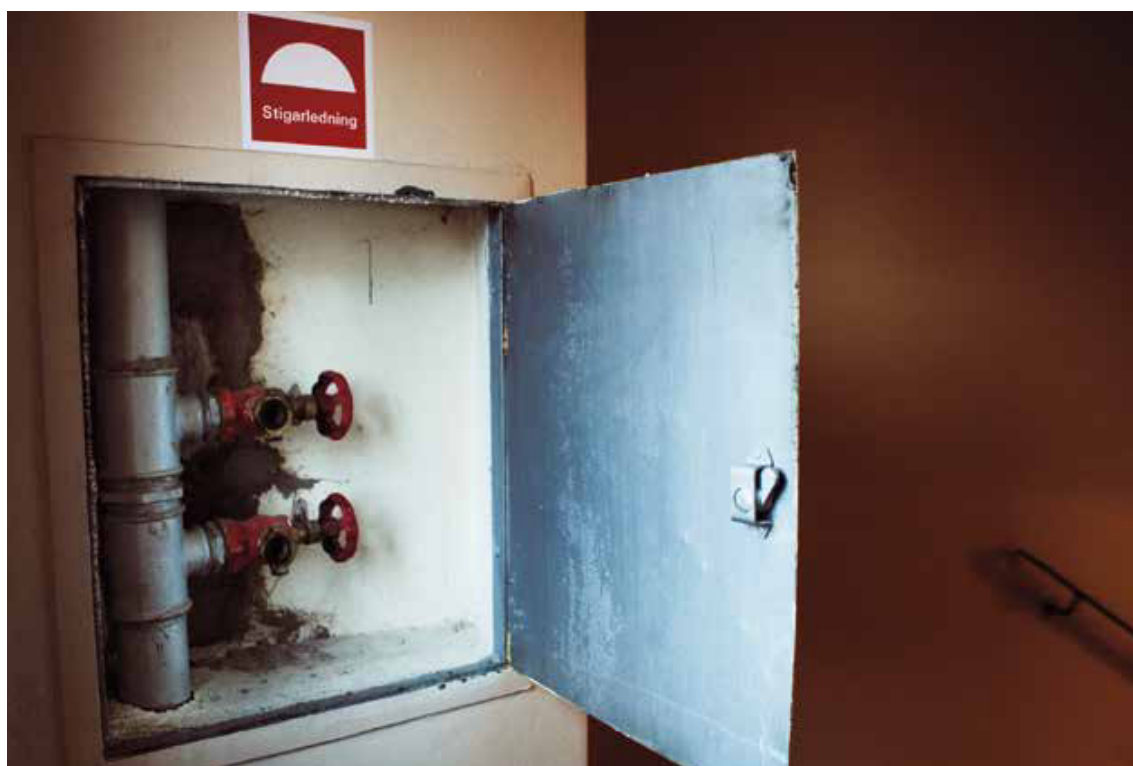
Via stigarledningen i trapphuset får räddningstjänsten vattenförsörjning utan att behöva dra slangar hela vägen från bottenvåningen.
